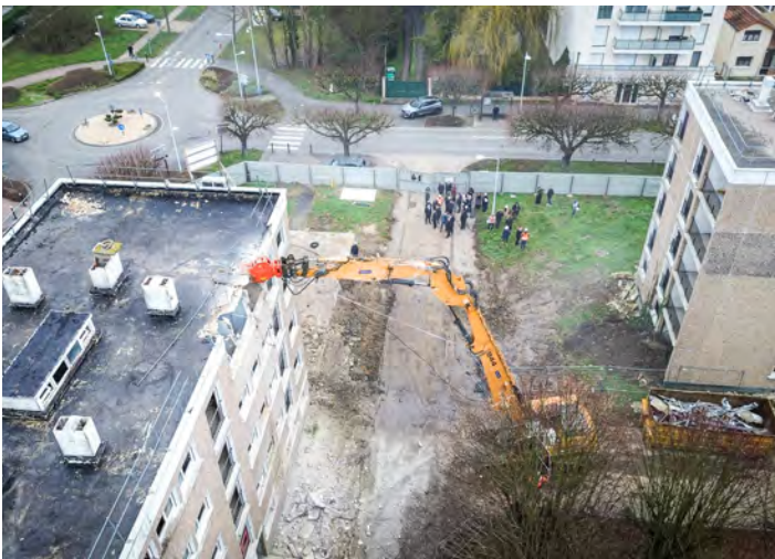
Premier "coup de pelle" de la démolition de la résidence du Parc, le 9 février 2026.
